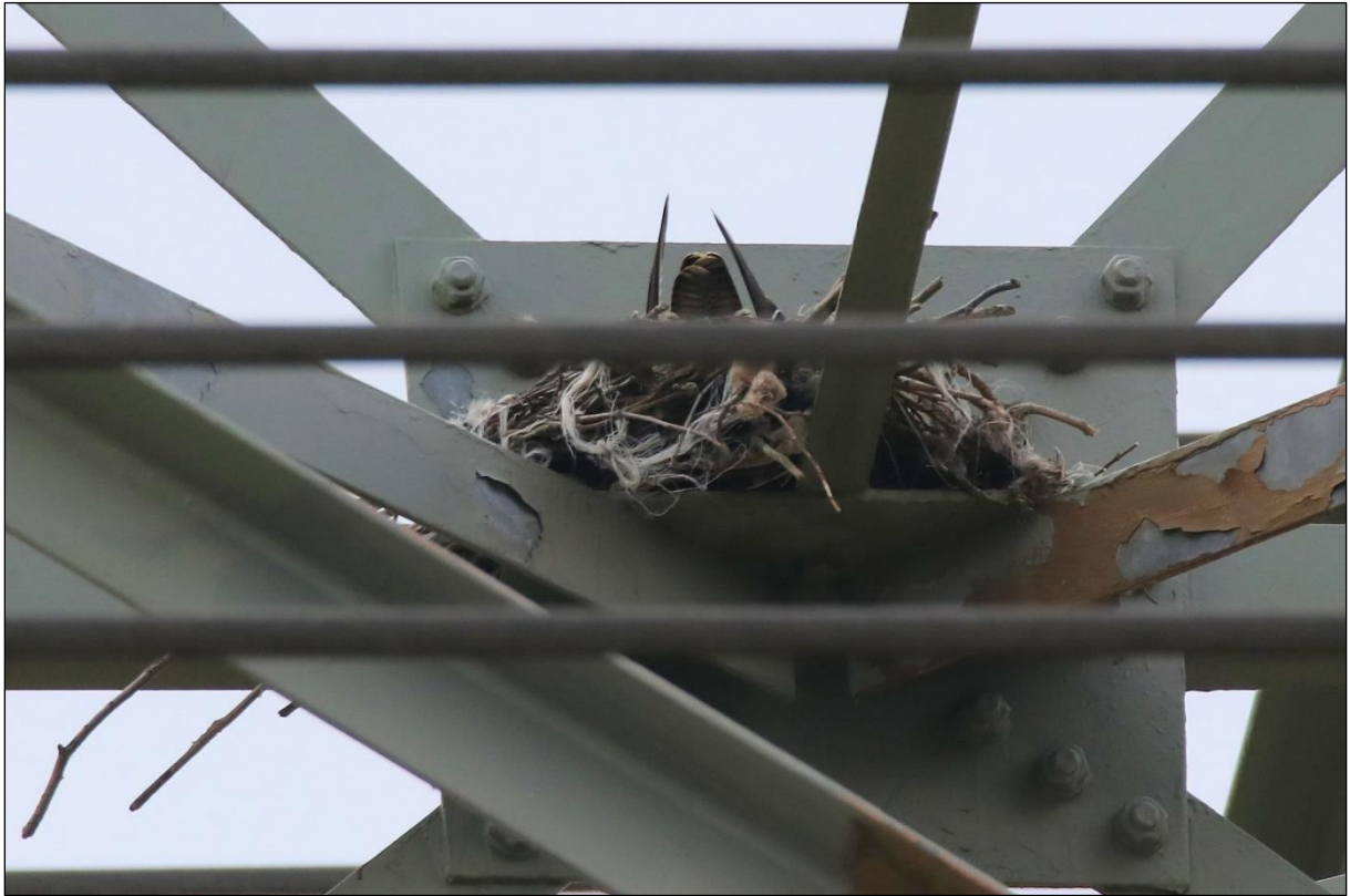
Slechtvalk in kraaiennest in hoogspanningsmast
